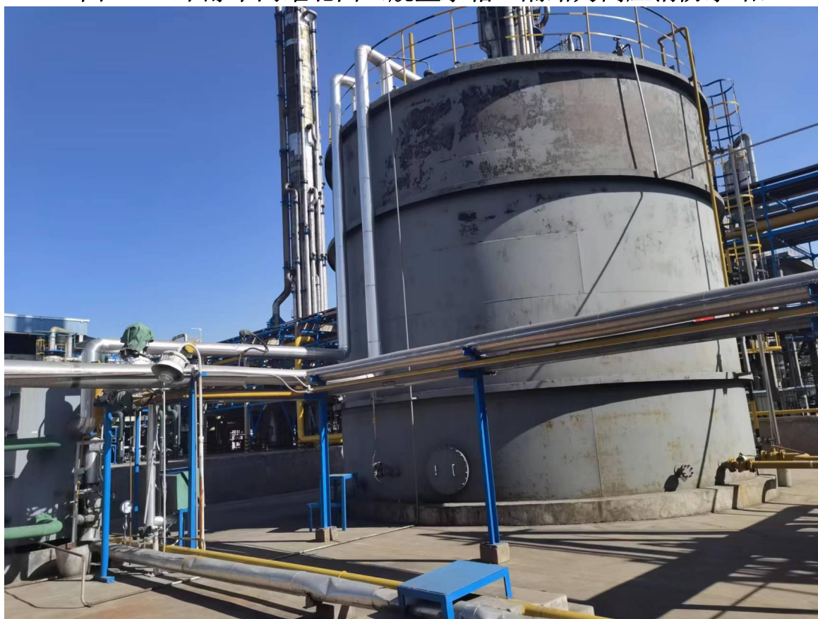
图 F1-4 甲醇中间罐南面（氨水储罐）
