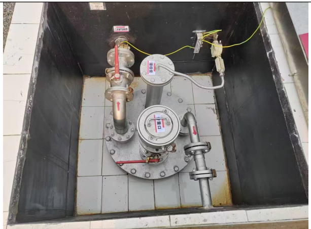
图 16 油罐量油口操作井
