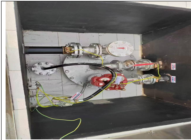
图 17 油罐潜油泵操作井
