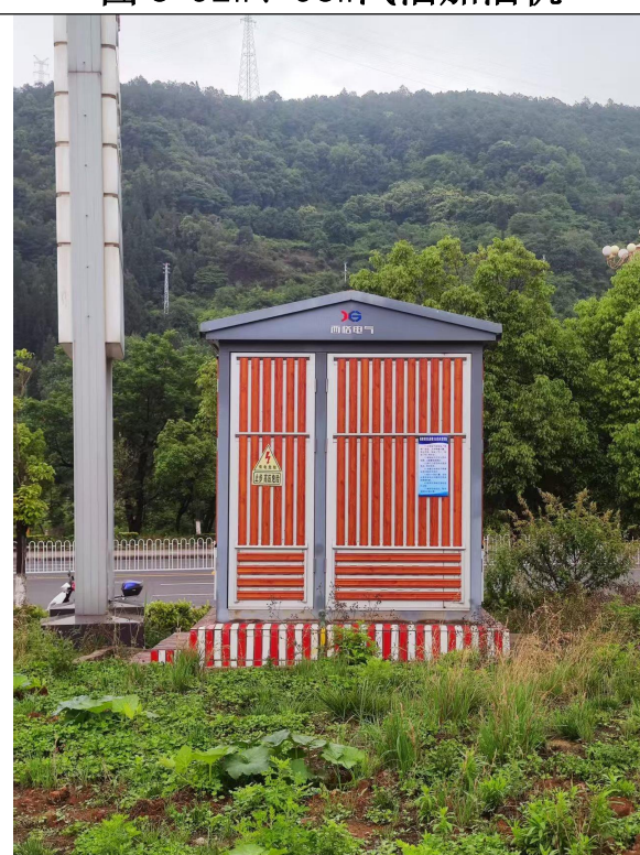
图 10 加油站 10KV 变电箱
