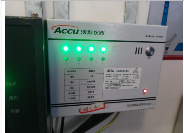
图 25 油罐测漏报警仪
