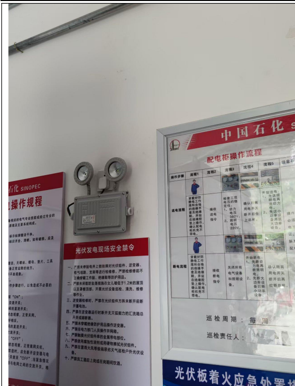
图 11 配电室应急照明灯
