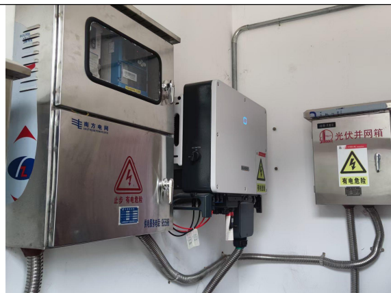
图 18 光伏逆变器及并网箱
