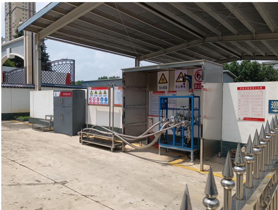
图6-3 L-CNG卸车装置
