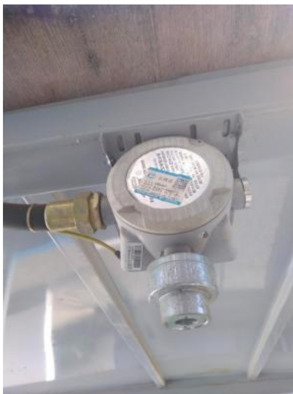
图8-8 LNG撬旁的防爆型可燃气体探测器
