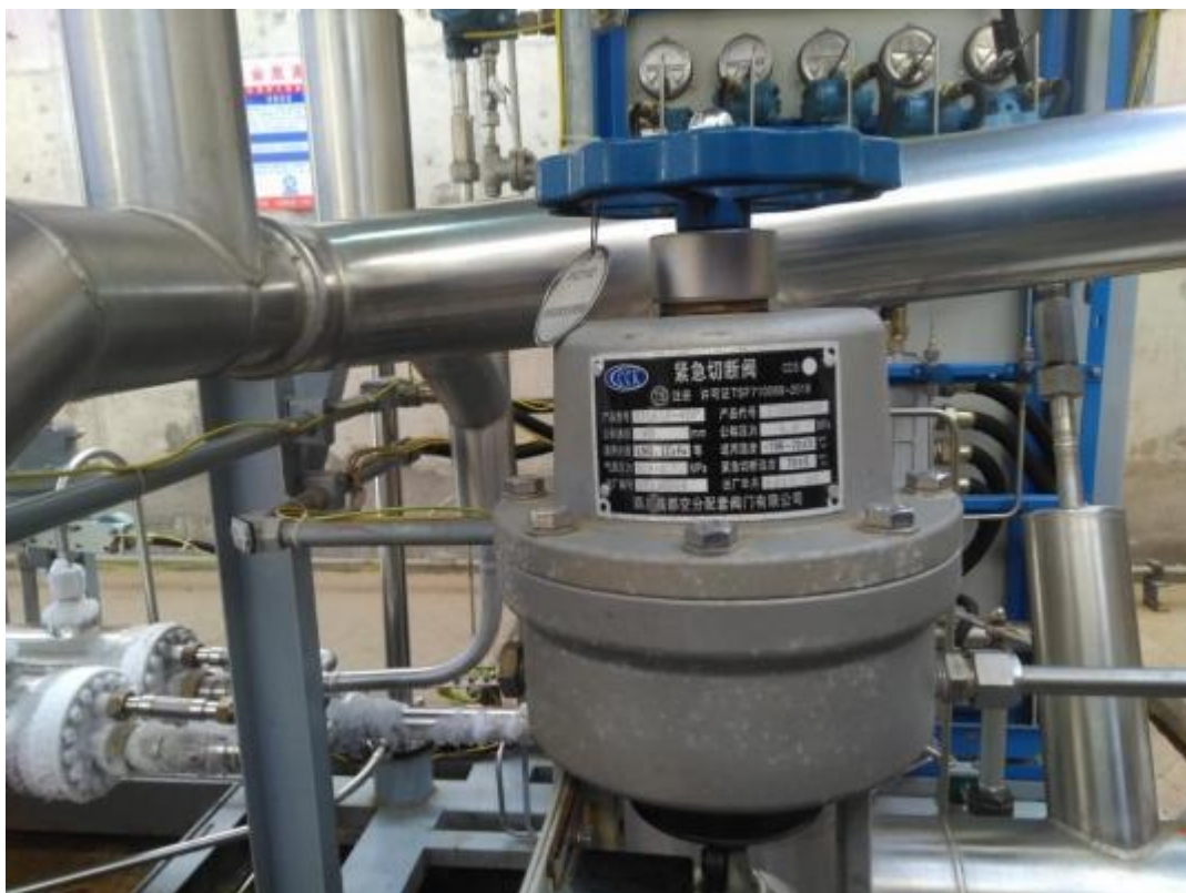
图6-7 LNG紧急切断阀
