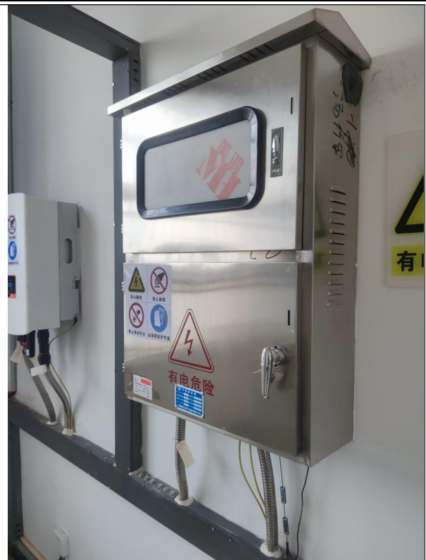
图 28 光伏并网配电箱
