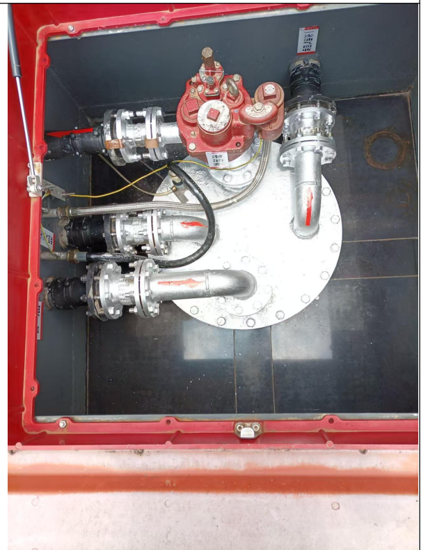
图 30 潜油泵操作井
