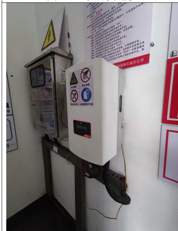
图 17 光伏逆变器及并网配电箱
