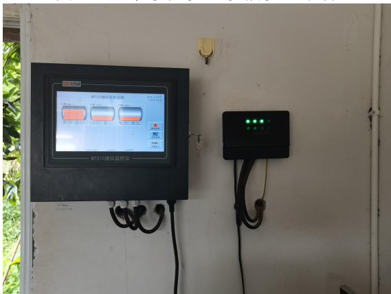
图 16 油罐液位仪、渗漏仪显示屏
