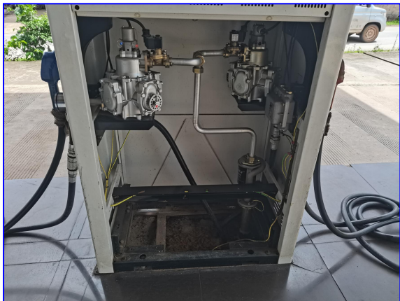
图 6 柴油加油机 0#-内部
