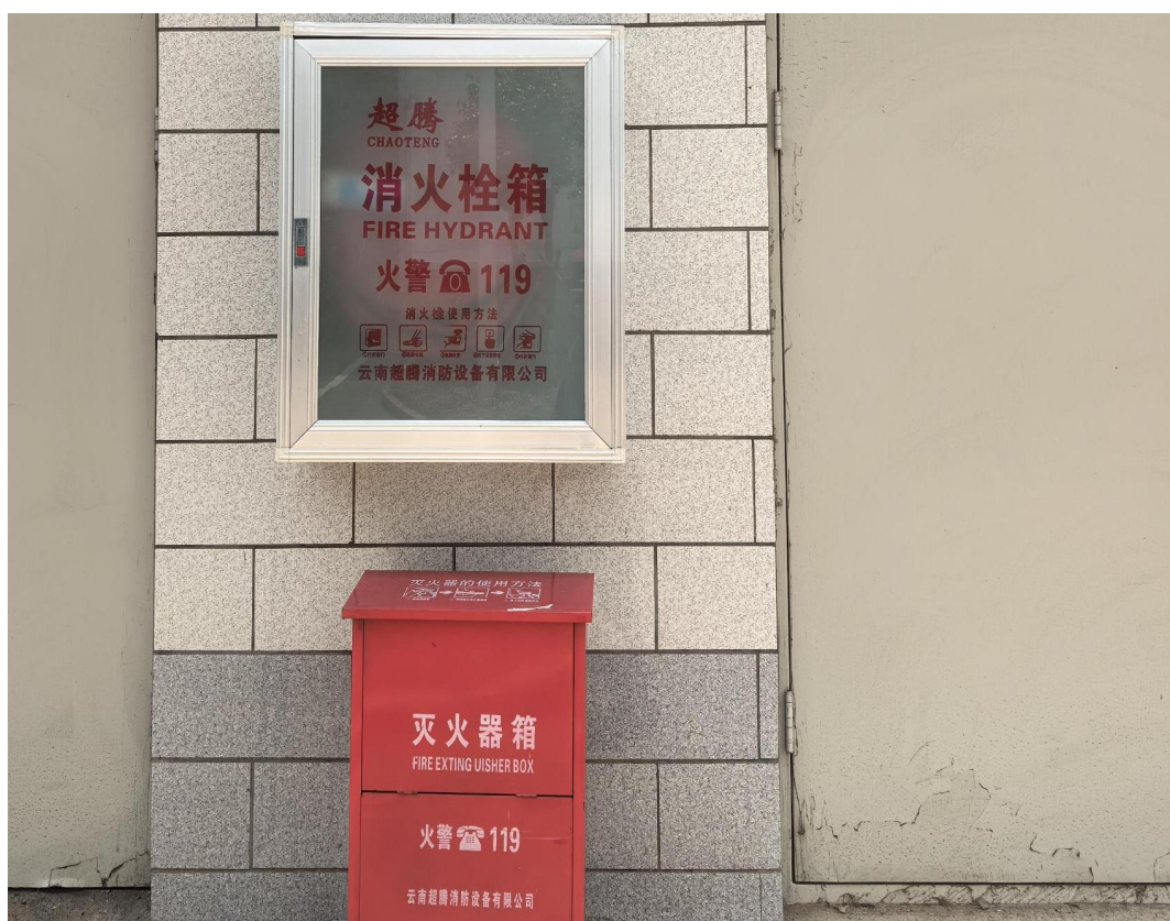
附图 1-8 消火栓、灭火器
